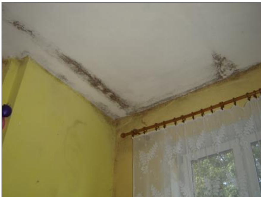
Zagrzybiony sufit świetlicy.
