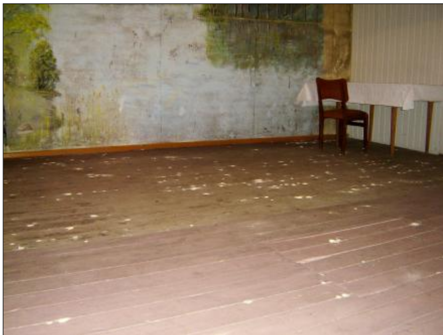
Podłoga sceny niszczona przez korniki.
